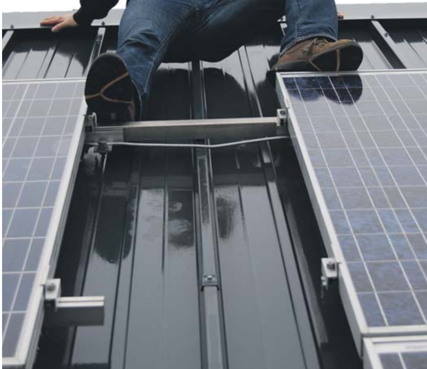
Dieter Ertwiens – hier auf dem Dach des Firmensitzes in Ostrhauderfehn – will mithelfen, dass eine Ambulanz und ein Waisenhaus in Kenia künftig ebenfalls Sonnenenergie nutzen können.
